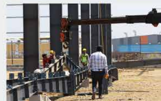
Eine Delegation von MAURER München mit Firmenleitung und Teil der Belegschaft von MAURER Sanfield India im Werk in Bhopal.
