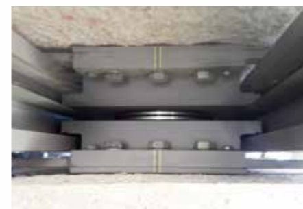
Achtung Spiegelbild! Das Lager (untere Hälfte) spiegelt sich im hochglänzenden Edelstahl-Gleitblech (oben). Oben und unten sind deshalb auch die Klammern gegen abhebende Kräfte doppelt zu sehen.
